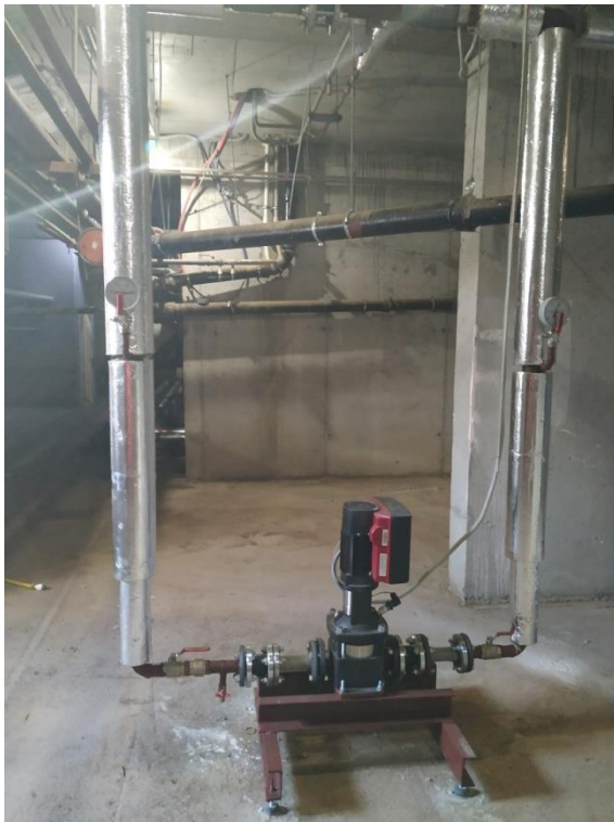
Установлены повысительные насосы, позволившие улучшить циркуляцию и напор.
